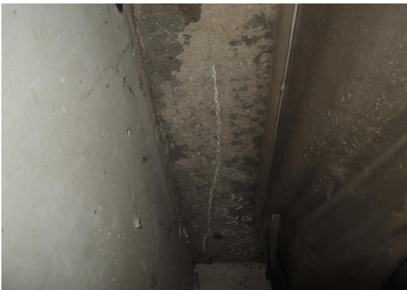
S1 바닥판 하면 균열(0.3mm/0.8m)
