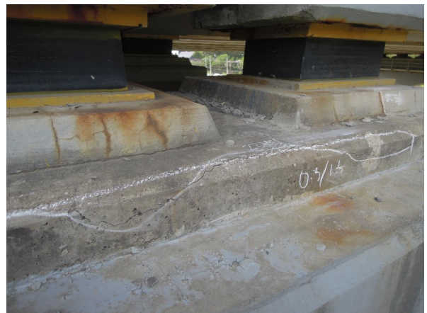
교각 P3-SH18 받침콘크리트균열(0.3mm/1.5m)
