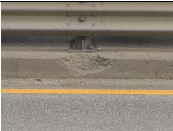
S9 중앙분리대 연석파손(0.5m×0.5m)
