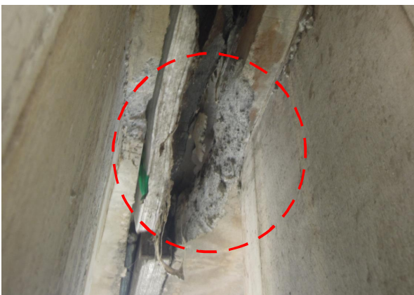
S3 바닥판 하면 파손(0.5m×0.2m)
